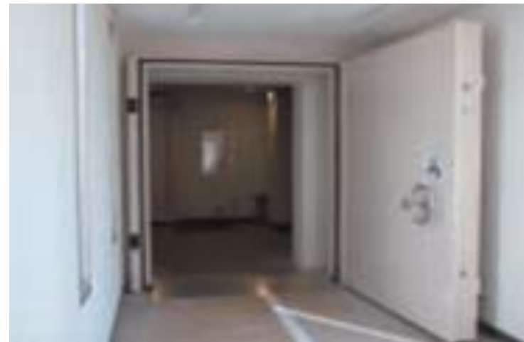
津波時の浸水防止のための水密扉 (東北電力・東通原発)
